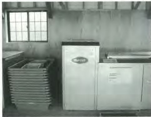
エコドーム東の資源有効利用整備施設 (生ごみ処理機設置施設)
