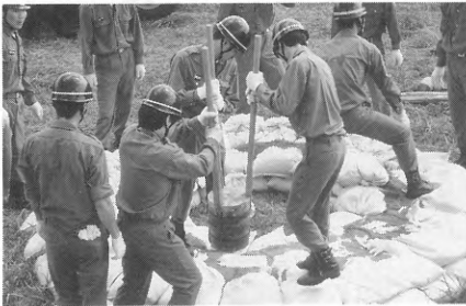
月の輪 (漏水防止)
